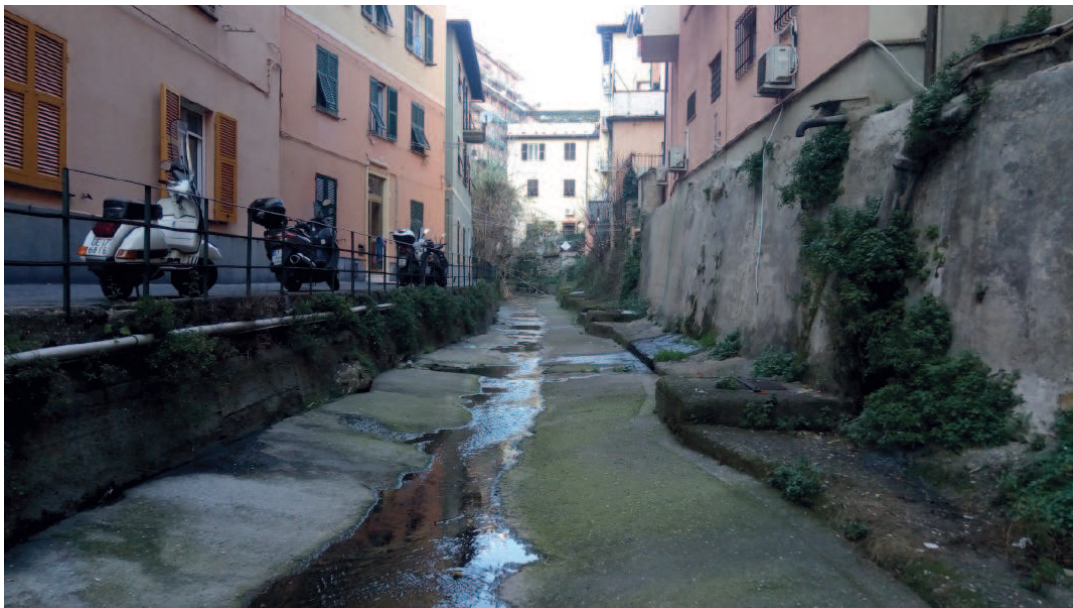
- Tratto di Via Oliveto, a monte della passerella da demolire, in cui è prevista la rimozione della ringhiera e la realizzazione di un parapetto in c.a. –
